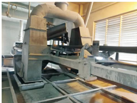
改造前皮带架上堆积大量电石灰
