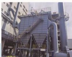
中泰化学40500KVA密闭电石炉炉前排烟除尘系统
