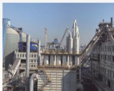
信发集团48000KVA密闭电石炉炉气净化回收系统
