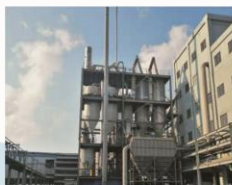
安徽华塑40500KVA密闭电石炉炉气净化回收系统
