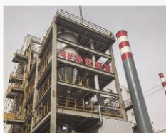
内蒙古君正81000KVA密闭电石炉炉气净化回收系统
